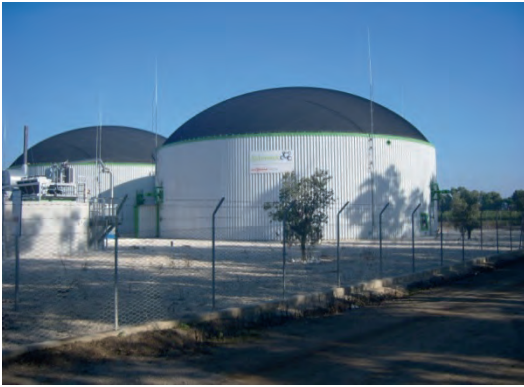
Figura 35: Cupola gasometrica (Fonte: Inail)
